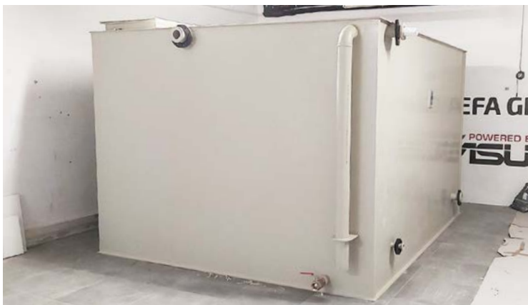
Zbiornik przeciwpożarowy 18 m 3 dla budynku biurowego
