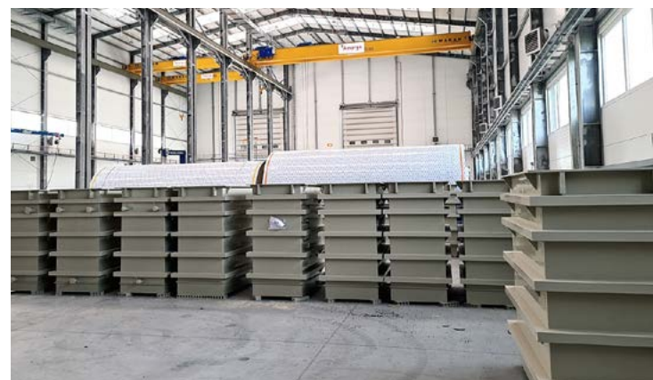
Zbiorniki procesowe (wanny trawialnicze) z wyposażeniem i orurowaniem zautomatyzowanej linii produkcyjnej elementów metalowych
