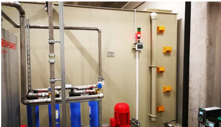
Zbiornik przeciwpożarowy dla budynku archiwum
