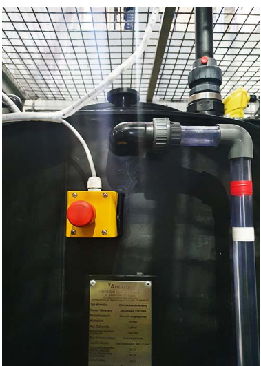
Fot. 4. Wyłącznik bezpieczeństwa umieszczony na zbiorniku technologicznym.
