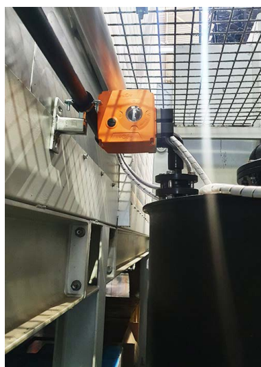
Fot. 5. Koniec instalacji tłocznej zabezpieczony dodatkowym zaworem odcinającym.
