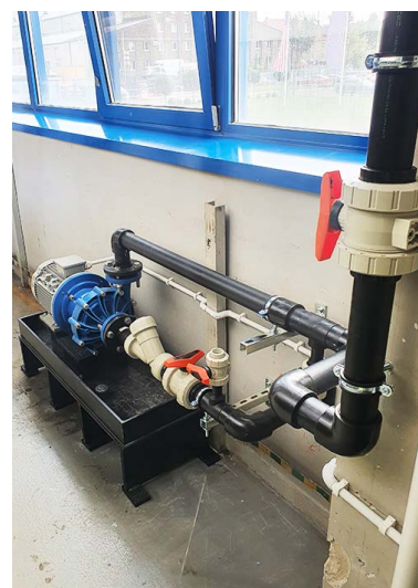
Fot. 6. Początek instalacji tłocznej z przyłączem umożliwiającym opróżnienie instalacji w przypadku prac serwisowych oraz zaworem odcinającym.
