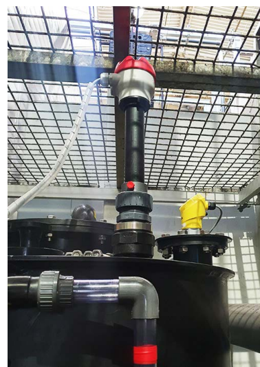
Fot. 3. Czujnik przepiętnia zbiornika.
