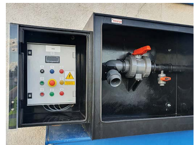
Fot. 9. Instalacja tankowania zbiornika z obudową i wanną wychwytową szczelną na ewentualne wycieki wyposażona w zawór odwadniający obudowę, dodatkowo szafa pomocnicza układu AKiP.
