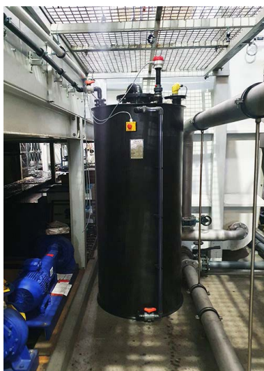
Fot. 2. Procesowy zbiornik technologiczny (buforowy).
