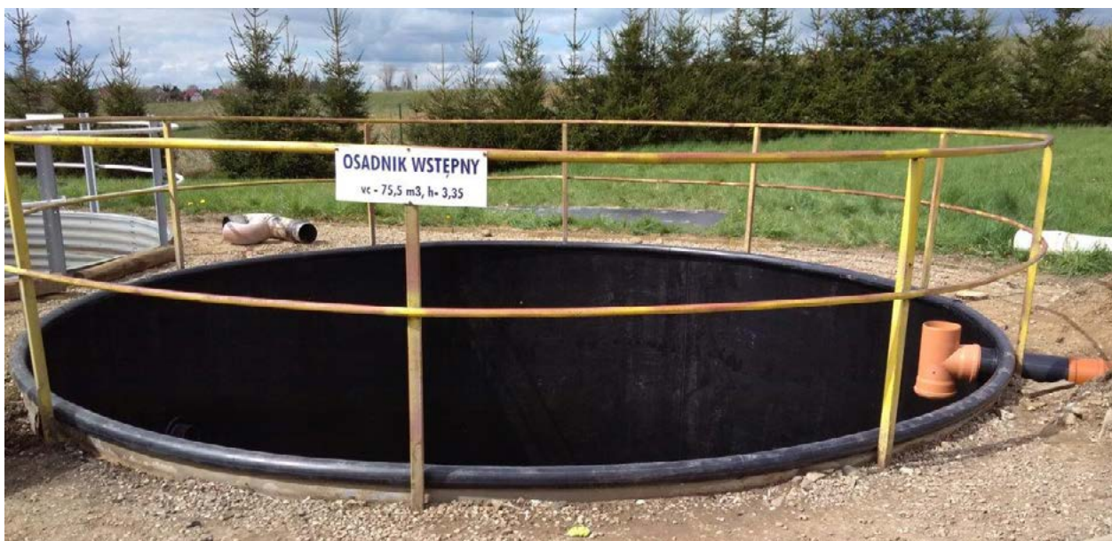
Fot. 9, 10, 11, 12. Stan osadnika po wykonaniu renowacji za pomocą czarnej wykładziny odpornej na działanie ścieków.
