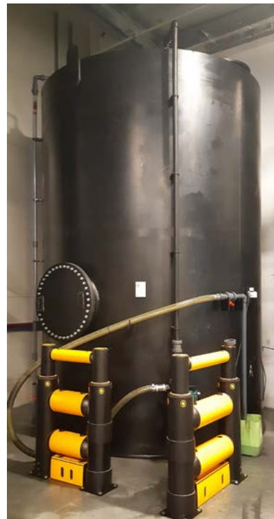
Zbiornik cylindryczny na popłuczynny wody z olejem wykonany w ramach optymalizacji kosztów i poprawy BHP (obiór odpadów jest tańszy z jednej zlewni niż z wielu mauzerów).
