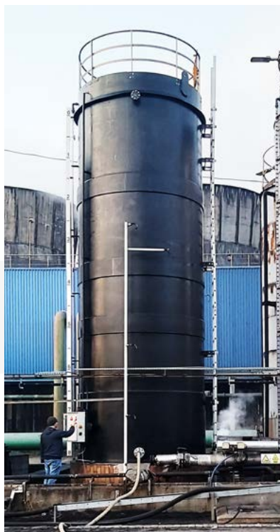
Zbiornik magazynowy tęgusodowego o pojemności 50 m 3 wykonany w ramach wymiany wyeksploatowanego, stalowego zbiornika, któremu skończył się okres żywotności.
