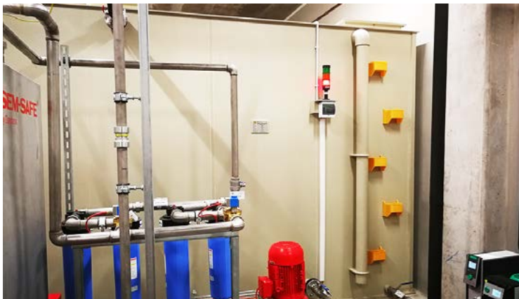
Zbiornik przeciwpożarowy dla budynku archiwum
