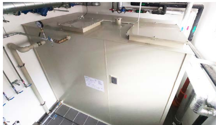
Zbiornik magazynowy wody pitnej dla ośrodka zdrowia
